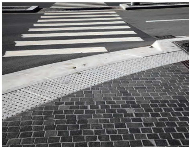
Visuelt og taktill oppmerksomhetsfelt og nedsenksdetalj i granitt med varselfelt for svaksynte ved fotgjengerfelt i Dronning Eufemias gate, Oslo.
