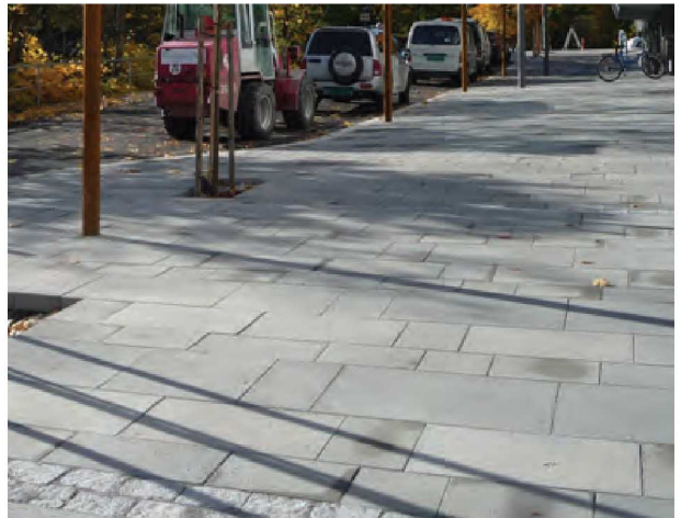
Referansebilde: betongheller på fortau
