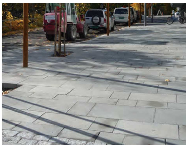
Referansebilde: betongheller på fortau
